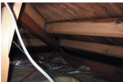
▲小屋裏が結露した状態
